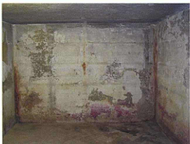
Feuchter Kellerboden und schimmelige Wände vereiteln jegliche Nutzung von Kellerräumen
